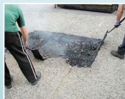
narušenie povrchu opravy
