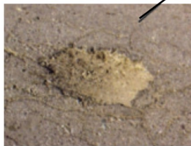
Veľké trhliny a malé výmole
